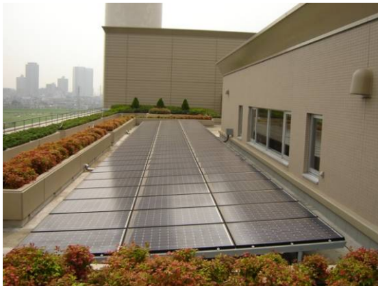
太陽光発電パネル（多摩川清掃工場）
