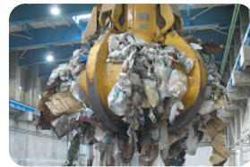
ごみクレーン
