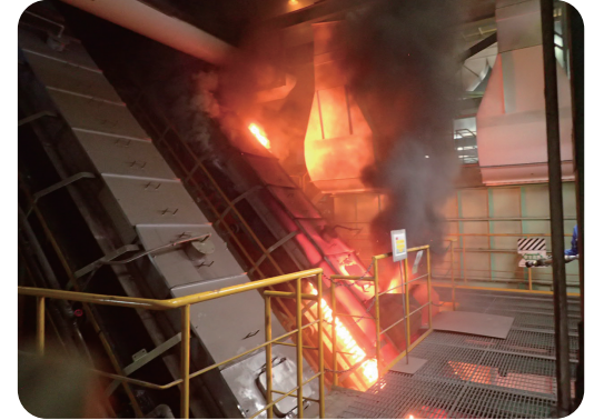
不燃ごみ処理センターでの火災
