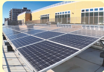
太陽光発電システム (光が丘清掃工場)
