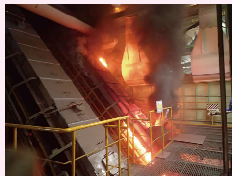
二次電池によるコンベヤ火災(中防不燃ごみ処理センター)
