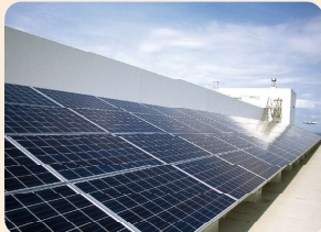
太陽光発電パネル(大田清掃工場)
