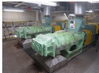
中防灰溶融施設 混練機
