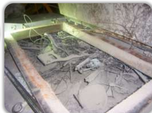
金属ごみによる灰押し出し装置の詰まり
