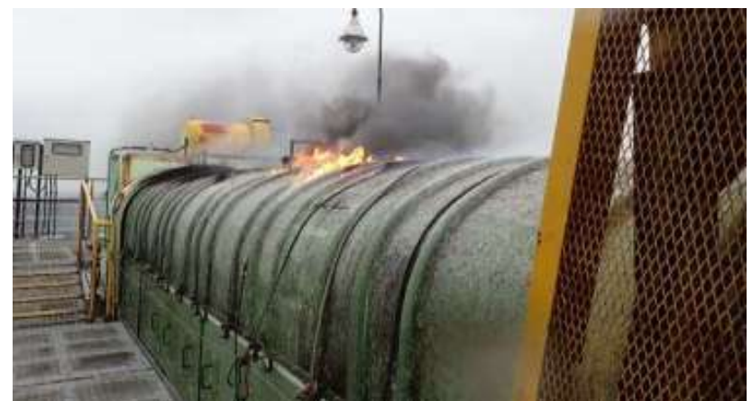
コンベヤ火災
