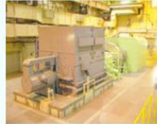
8 発電機とタービン
