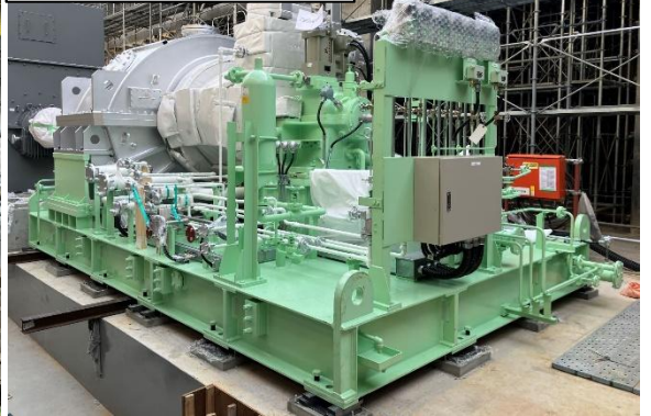
蒸気タービン発電機
