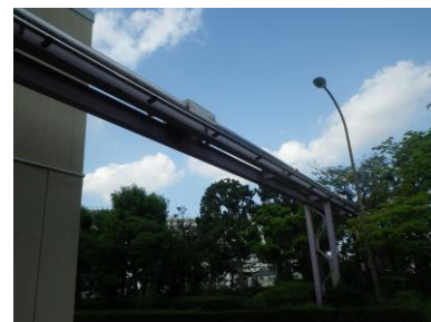
高温水を送るパイプ
