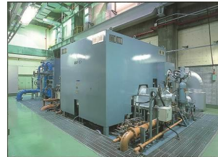
蒸気タービン発電機
