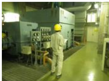
蒸気タービン発電機日常点検
