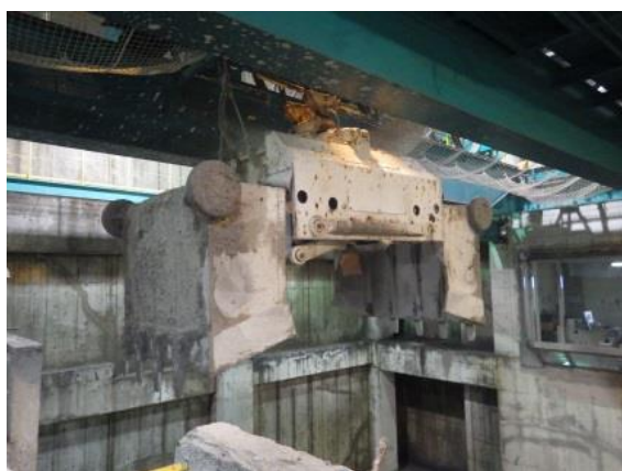
<稼働中の更新前の灰クレーン>
