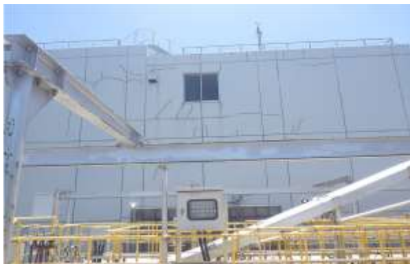
<ひび割れた外壁と錆汁の跡>
