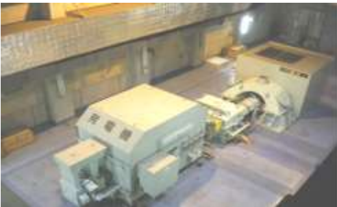
<蒸気タービン発電機>
