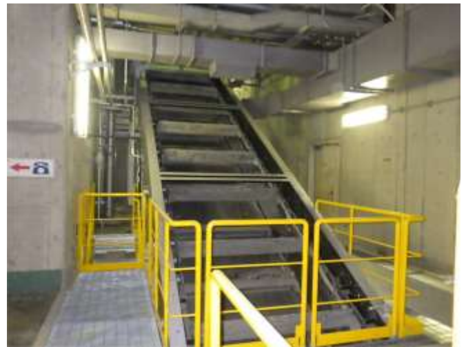
< 写真3 灰コンベヤ >
