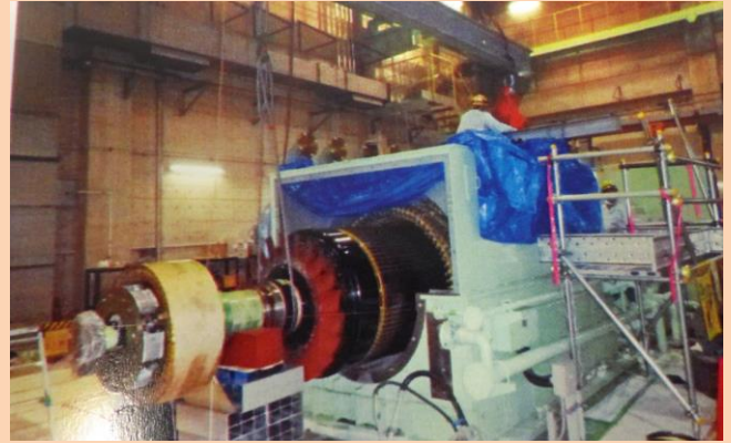
《タービン発電機の精密点検》
