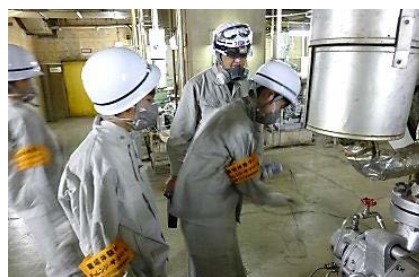
設備機器の保守点検業務
