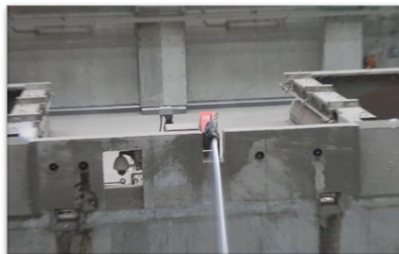
放水銃の放水の様子
