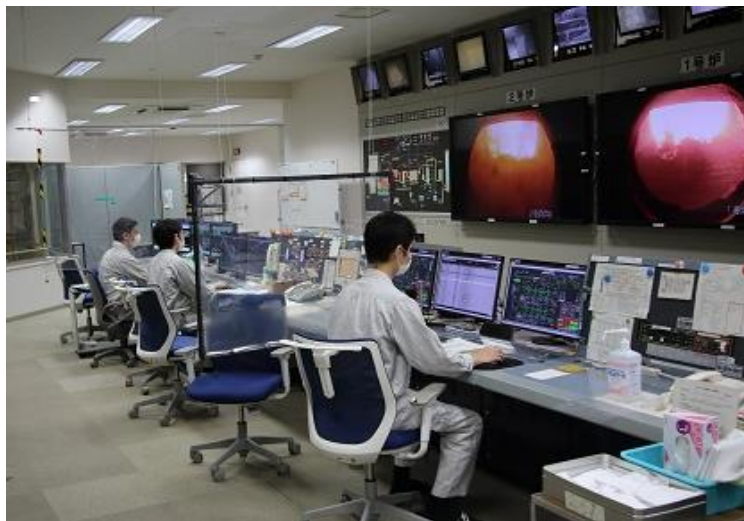
【中央制御室】 飛沫防止対策用のフィルムを設置
