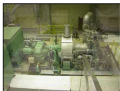
蒸気タービン 発電機
