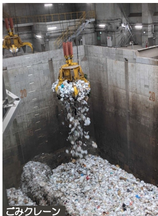
ごみクレーン
