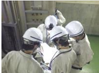
非常用発電機の点検の様子
