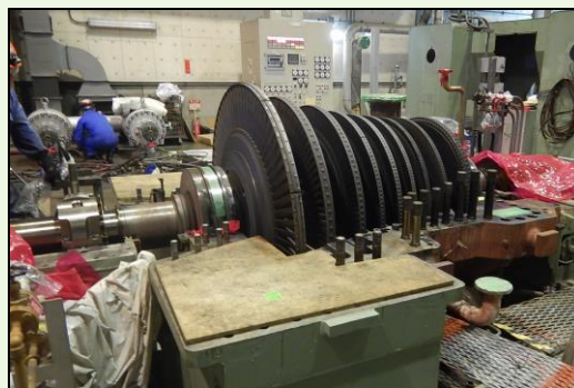
開放点検中の蒸気タービン
