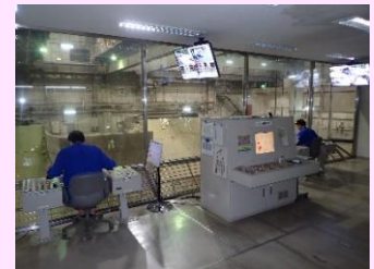
ごみクレーン操作室の様子
