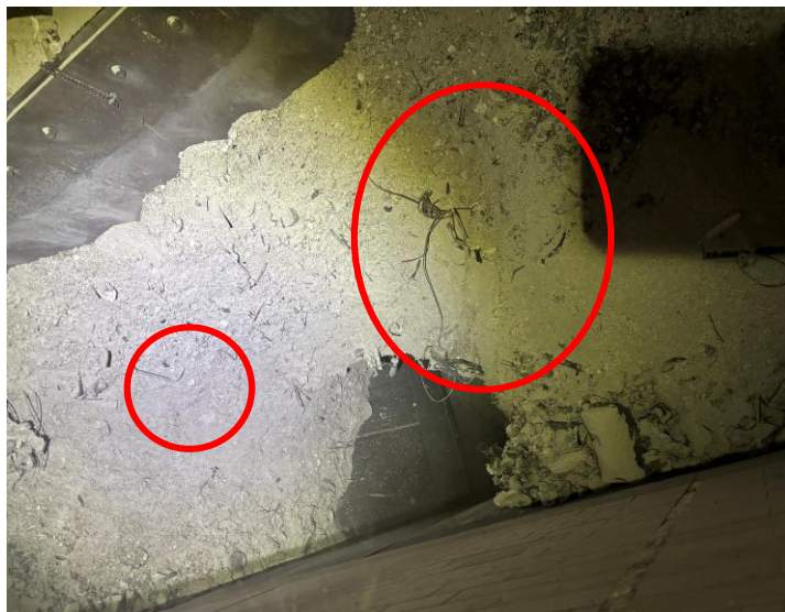
灰を運び出す設備が詰まった様子
