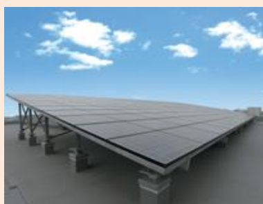
太陽光パネル
