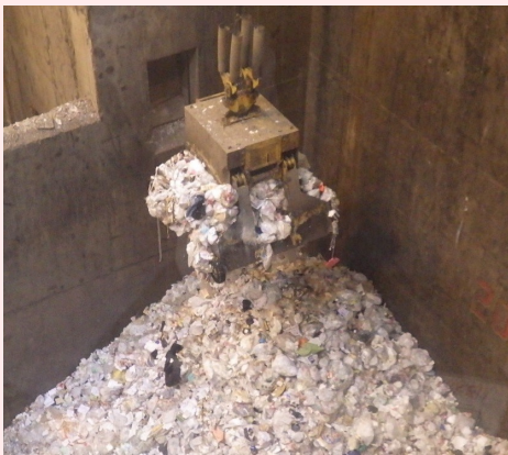
世田谷清掃工場のごみクレーン
