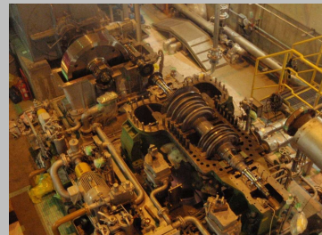
蒸気タービン(開放点検中)
