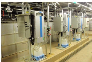
汚水処理設備
