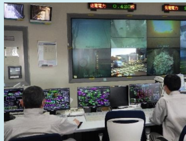
中央制御室での監視の様子
