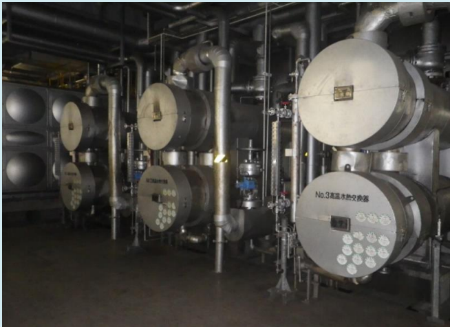
品川清掃工場内の余熱利用設備
