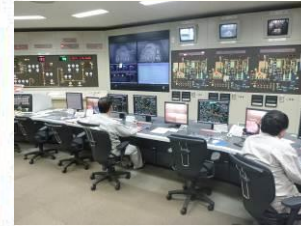
②⑤中央制御室
