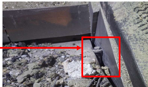
可動部に挟まったボルト
