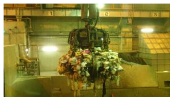
ごみクレーン
