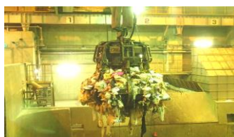
ごみクレーン
