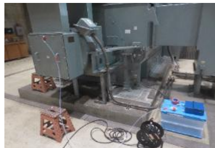
発電機内のオゾン濃度測定
