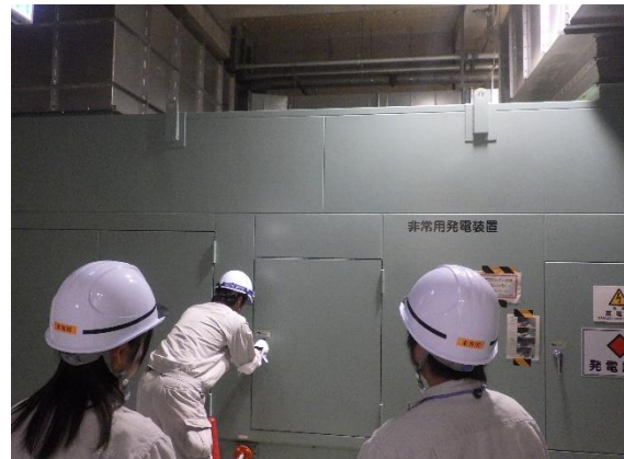
設備の点検業務
