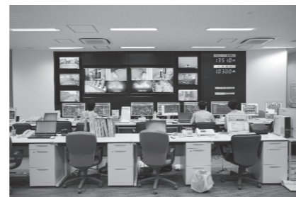
中央控制室 (练马垃圾焚烧处理厂)
