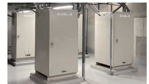
排ガスの自動測定機（板橋清掃工場）
