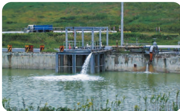
ポンプ井（集水池）
