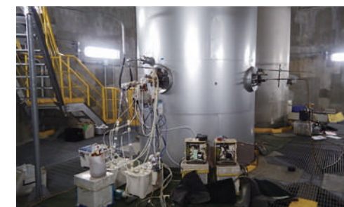
排ガス採取の状況（杉並清掃工場）
