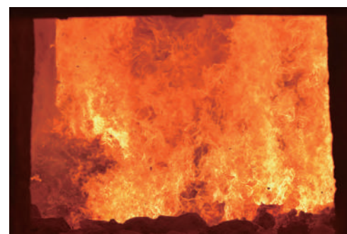
焼却炉内部の様子（杉並清掃工場）
