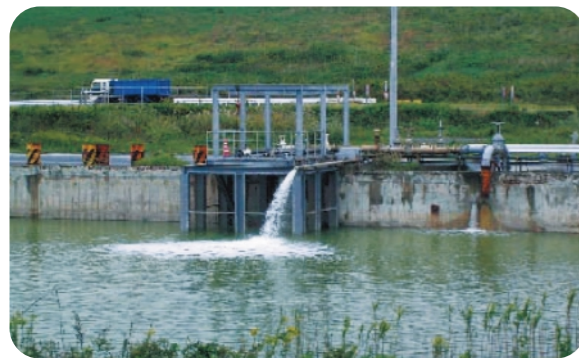
ポンプ井 (集水池)
