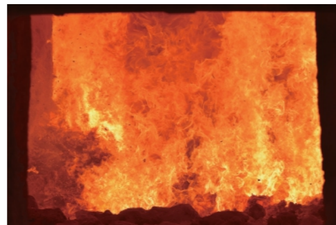
焼却炉内部の様子 (杉並清掃工場)
