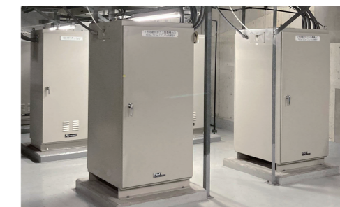
排ガスの自動測定機（板橋清掃工場）
