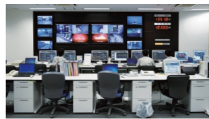
中央制御室(練馬清掃工場)
