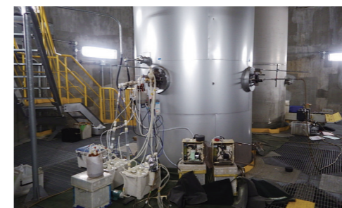
排ガス採取の状況（杉並清掃工場）
