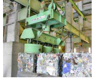
鉄分貯留搬出クレーン
