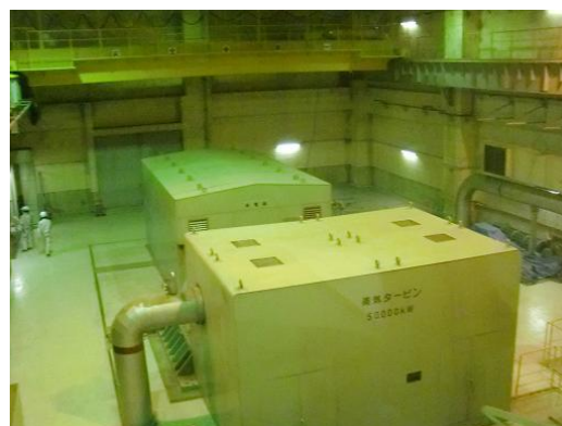
新江東清掃工場蒸気タービン発電機
