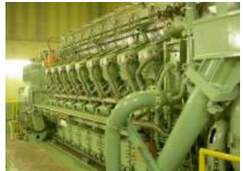
▲大田清掃工場ガスエンジン
