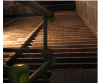
▲「ごみ焼却炉の内部」の火格子
