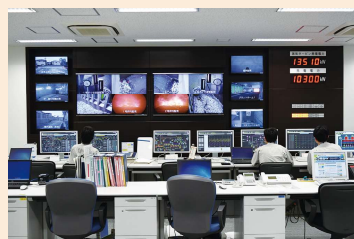
各設備の運転操作と監視をする中央制御室
