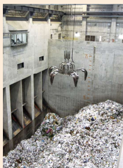
ごみバンカ・ごみクレーン
