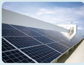
太陽光発電パネル(大田清掃工場)
