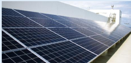
太陽光発電パネル(大田清掃工場)
