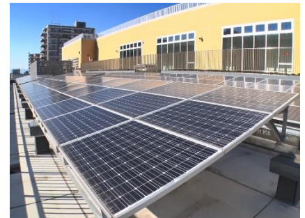
太陽光発電設備
