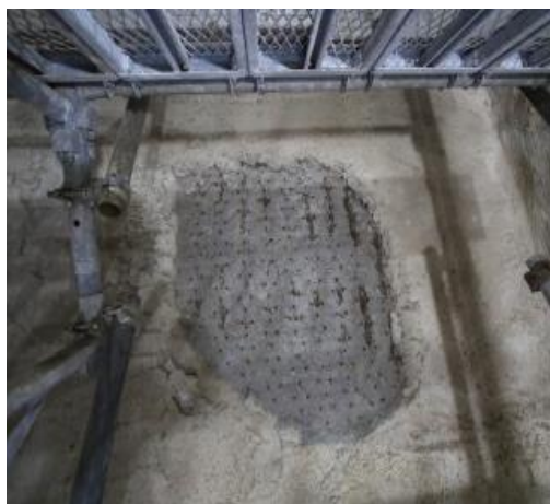
【焼却炉内の耐火物脱落】
