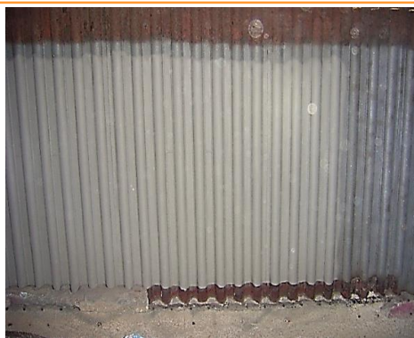
【整備後のボイラ水管】
